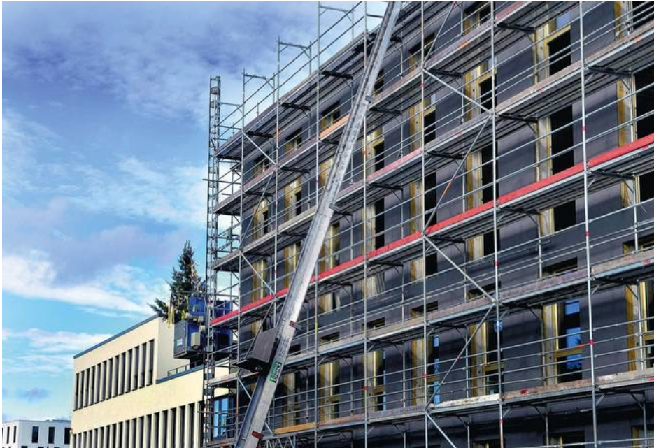
Der neue Bürokomplex "Eastsite VIII" im Stadtteil Neuostheim wird in Leichtbauweise mit sogenanntem Textilbeton hergestellt. Foto: vaf
